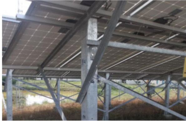
Gambar 2. 16 Penggunaan Tiang Galvanis pada Rangkaian Panel Surya
