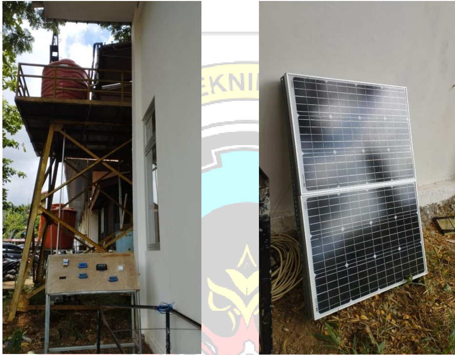
Gambar 4.1 Pembangkit Hybrid PLTS dan Pembangkit Listrik Berbasis Tenaga Air Hujan
