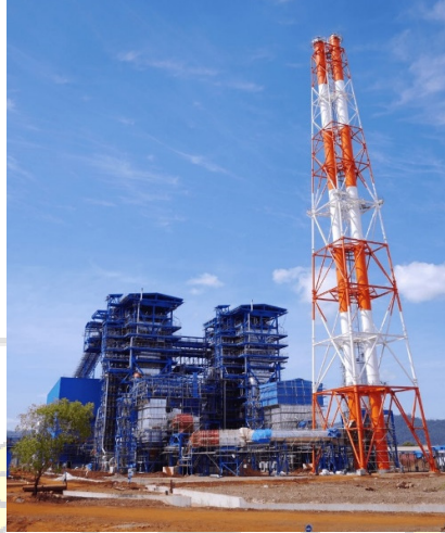
Gambar 2.3 PLTU Antam Pomalaa 2 x 30 MW
