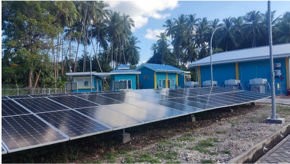
Gambar 4.5 String array modul surya PLTS Selayar
