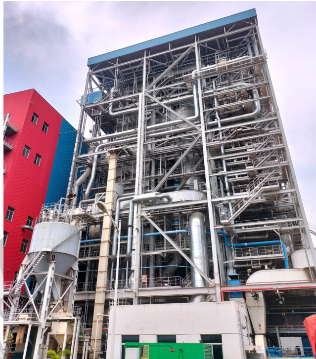
Gambar 2. 5 Boiler CFB PT PLN Nusantara Power Unit Pelaksana Pembangkitan Punagaya 2x100 MW Unit 1 (Sumber: Penulis, 2022)
