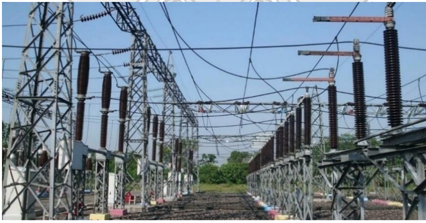
Gambar 2.2 lokasi PMT 150 kV (Sumber: Rahmat Hidayat dkk, 2021)
