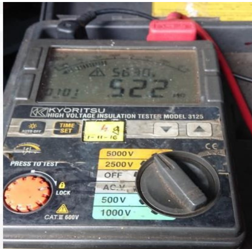
Gambar 4.12 Pengukuran phase R 11,5 kV
