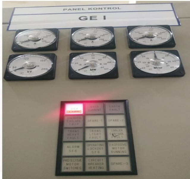
Gambar 4.3 Display Alarm pada Panel GI 150 kV (Sumber: Ruang Local Control ULPLTG Tello, 2021)
