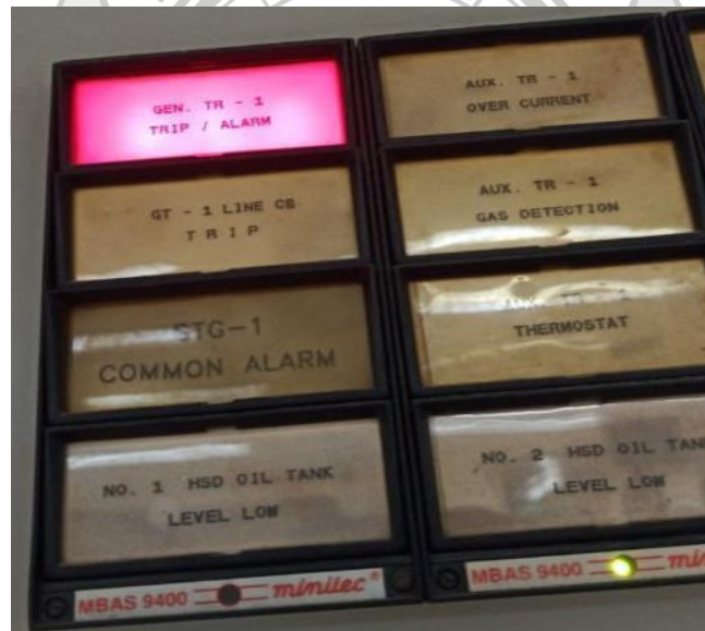
Gambar 4.2 Display Alarm Pada Panel Mimik (Sumber: Local control General electric#1, 2021)
