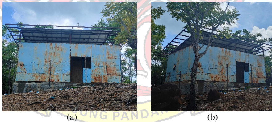
Gambar 4.6 Tampak Lokasi PLTS (a) Dari Depan, (b) Dari Samping
