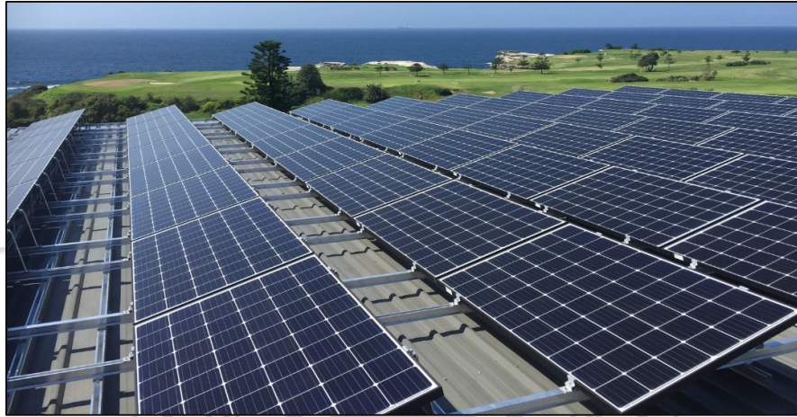
Gambar 2.1 Pembangkit Listrik Tenaga Surya (Sumber: ICAsolar, 2022)
