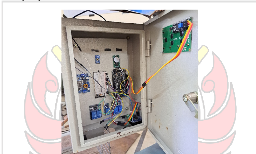
Gambar 4. 4 Komponen Elektronik pada Panel Box
