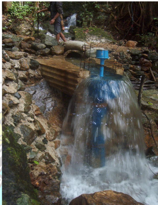
Gambar 2. Pemasangan pembangkit listrik tenaga picohydro tipe propeller
