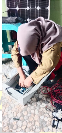
Pemasangan Komponen Elektronik
