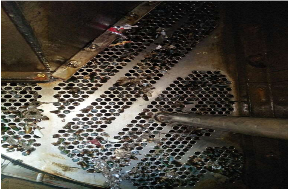
Gambar 2.4 Kerang pada pipa-pipa kondensor di PLTU PT. Semen Tonasa (Sumber: Arsip PLTU PT. Semen Tonasa, 2018)
