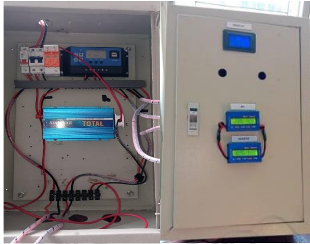
Gambar 4.2 Panel Box sistem kelistrikan
