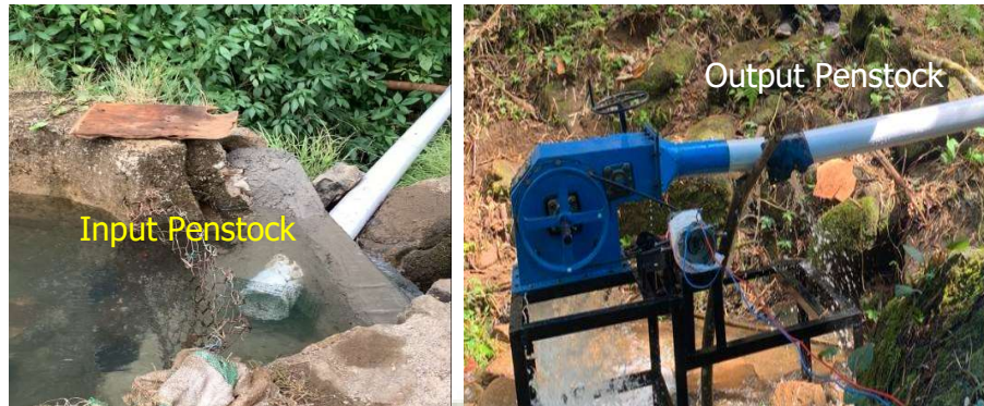
Gambar 4. 2 Instalasi Pemipaan Sumber : Dokumen pribadi
