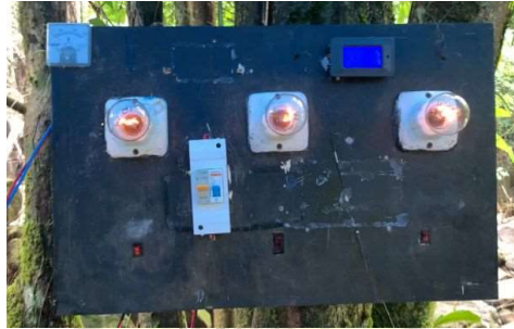
Gambar 4. 4 Instalasi Lampu Beban Sistem AC (Lampu Pijar)
