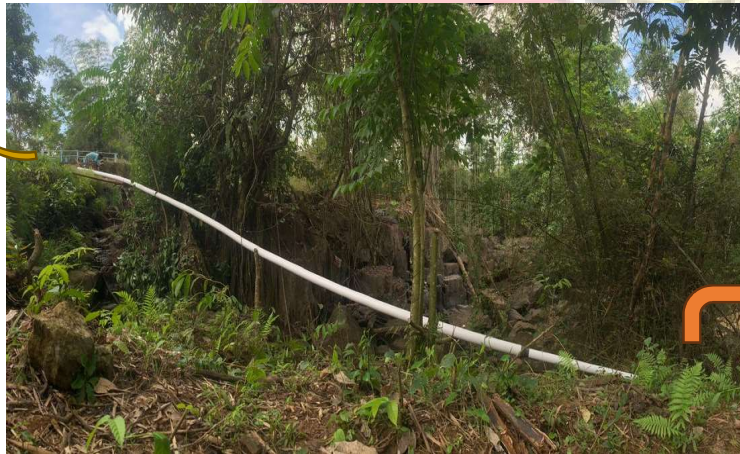
Gambar 3. 1 Instalasi Pengujian PLTMH sumber: Dokumen Pribadi
