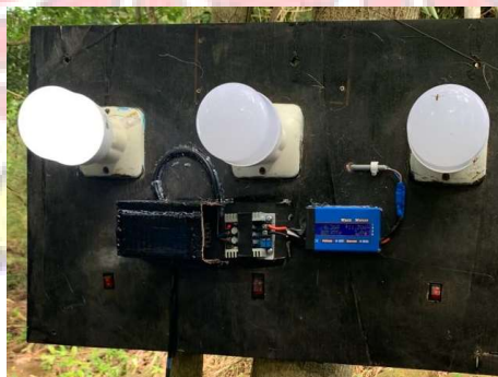
Gambar 4. 3 Instalasi Lampu Beban Sistem DC (Lampu LED) Sumber: Dokumen pribadi
