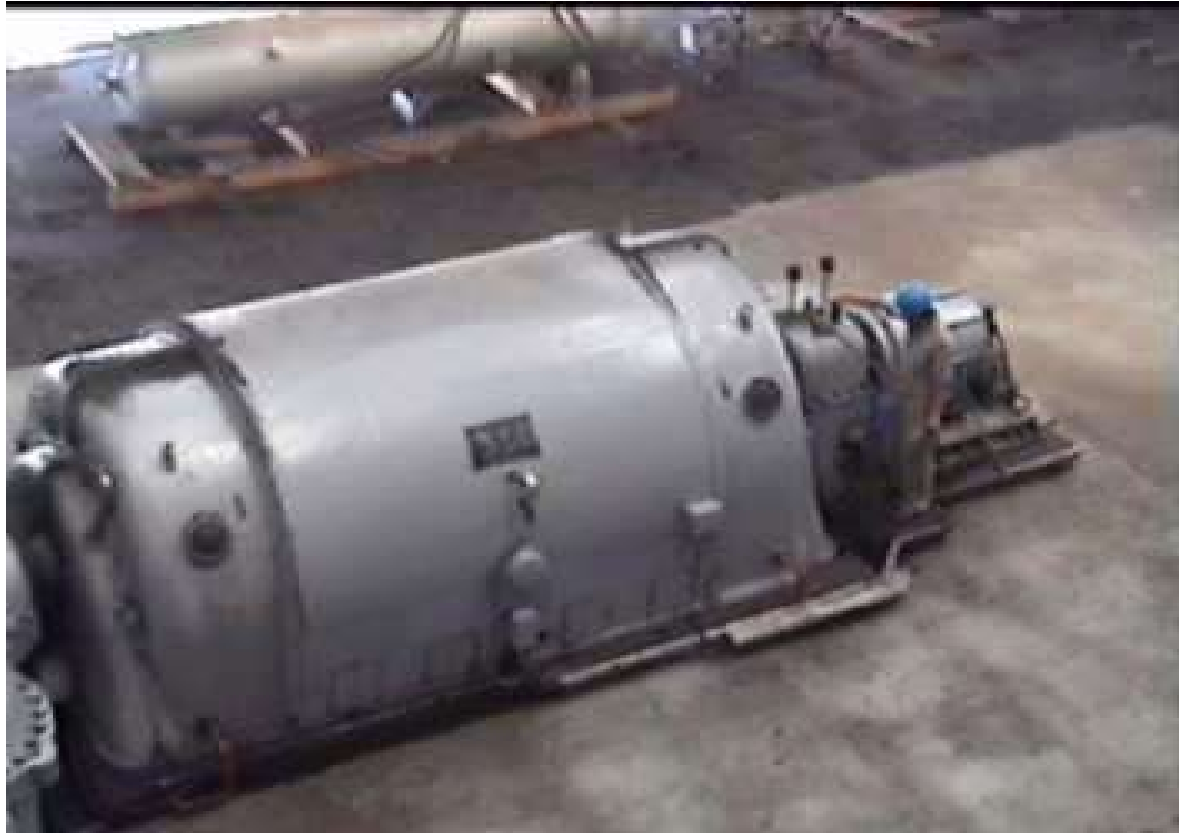
Generator Sinkron Buatan China PLTU BTG PT. Semen Tonasa
