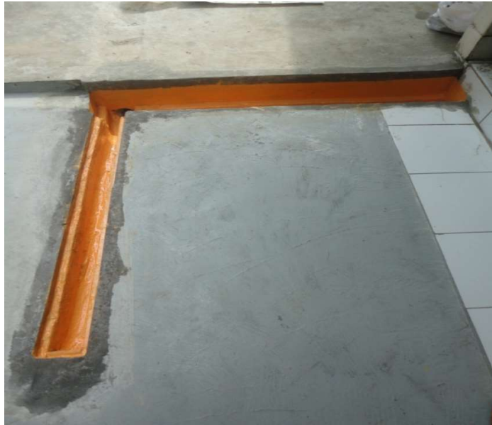
Gambar 11. Tempat Pipa hidrolik
