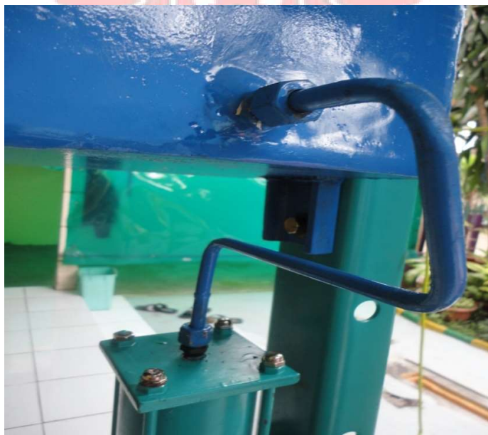
Gambar 36. Pipa Sambungan Tangki Atas dan Tangki Bawah
