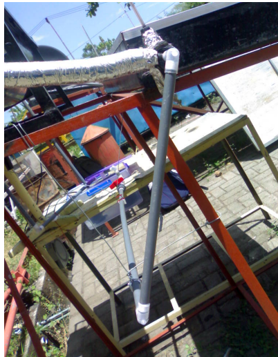
Foto 6. Rangkaian Pipa Fluida Output Kolektor
