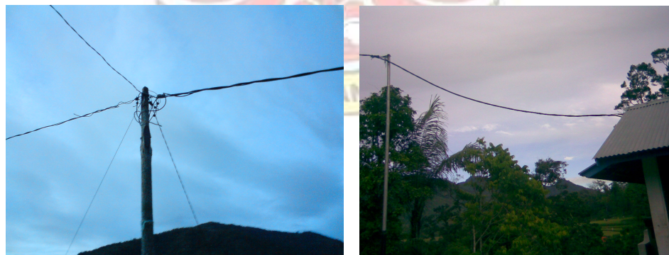
Gambar 62. Saluran Transmisi PLTMH di Desa Bungin Kab.Enrekang
