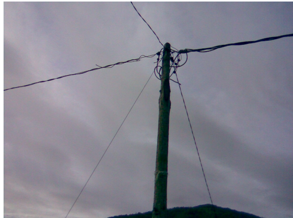
Gambar 17. Saluran Transmisi dan Distribusi pada PLTMH Bungin Kab. Enrekang.
