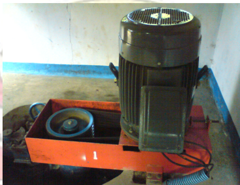
Gambar 46. Generator unit pembangkit I tampak dari samping
