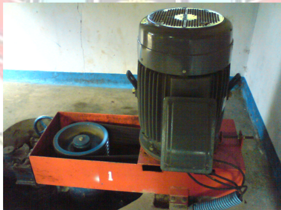
Gambar 23. Generator pada PLTMH Bungin Kab. Enrekang
