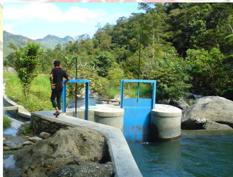
Gambar 59. Pintu air pada bendungan PLTMH di Desa Bungin Kab.Enrekang
