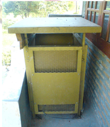
Gambar 25. Load stabilizer PLTMH Bungin Kab. Enrekang
