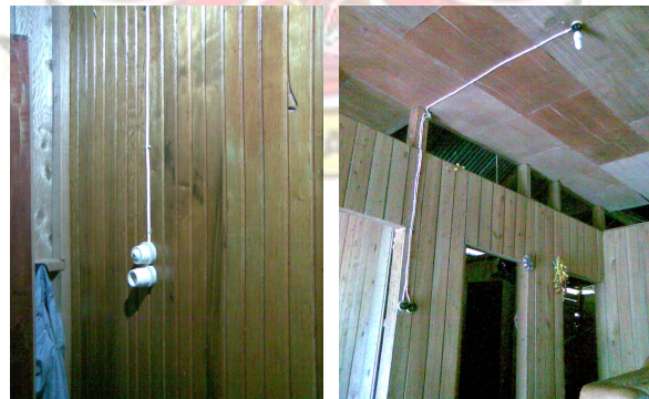
Gambar 56. Kondisi instalasi listrik rumah di Desa Bungin Kab. Enrekang
