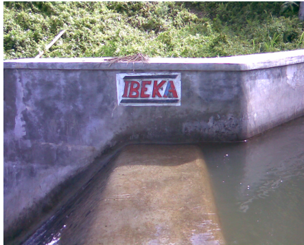
Gambar 66. Nama Kontraktor yang menangani bendungan PLTMH
