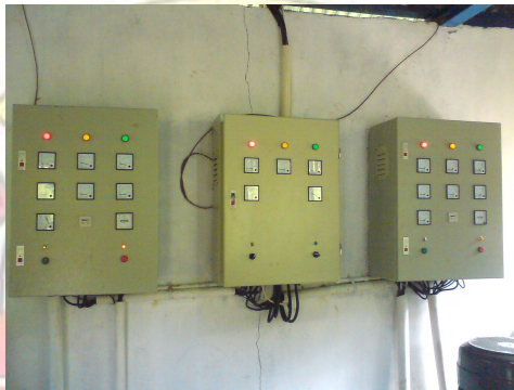
Gambar 52. Panel kontrol pada PLTMH Bungin Kab. Enrekang
