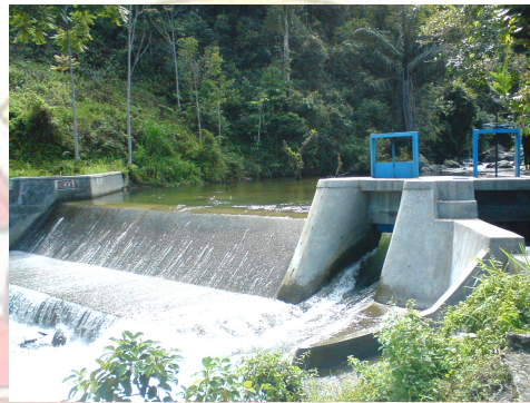
Gambar 58. Bendungan PLTMH di Desa Bungin Kab.Enrekang
