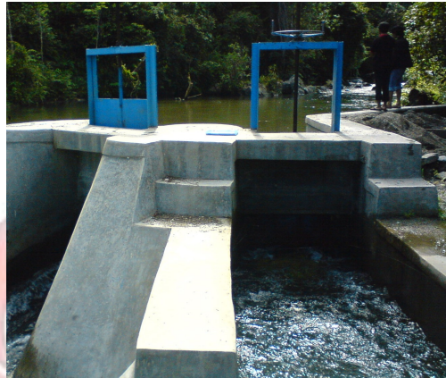
Gambar 2. Tempat Pemasukan Tipe Direct PLTMH Bungin Kab. Enrekang
