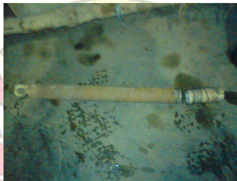
Gambar 73. Kondisi Ballast yang rusak pada PLTMH Bungin Kab.Enrekang
