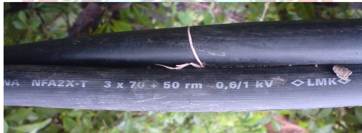
Gambar 18. Kabel Transmisi pada PLTMH Bungin Kab. Enrekang.
