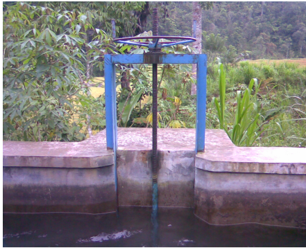
Gambar 63. Pintu penguras bak penenang PLTMH di Desa Bungin Kab.Enrekang
