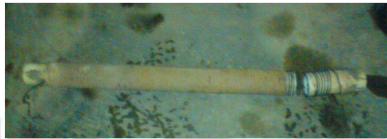
Gambar 27. Batang pemanas yang rusak pada PLTMH Bungin Kab. Enrekang
