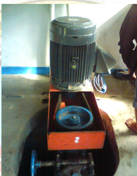
Gambar 49. Generator unit pembangkit II tampak dari depan
