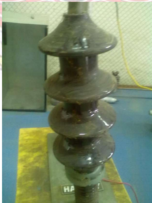
Foto 2. Isolator Keramik Line Post 60 KV (Terpolusi)
