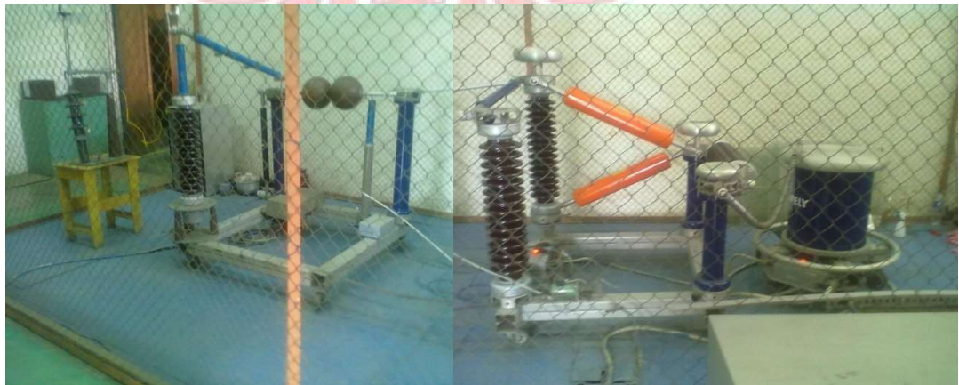
Foto 4. Rangkaian Tegangan Tinggi Untuk Pegujian Isolator Keramik 60 KV Pada Leboratorium Teknik Konversi Energi Politeknik Negeri Ujung Pandang.
