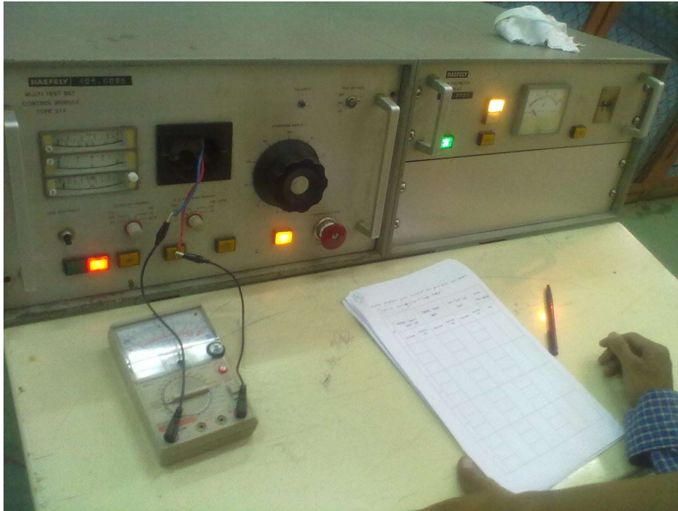
Foto 3. Panel Kontrol untuk pengujian Isolator pada Laboratorium Tegangan Tinggi Program Studi Teknik Konversi Energi Politeknik Negeri Ujung Pandang.
