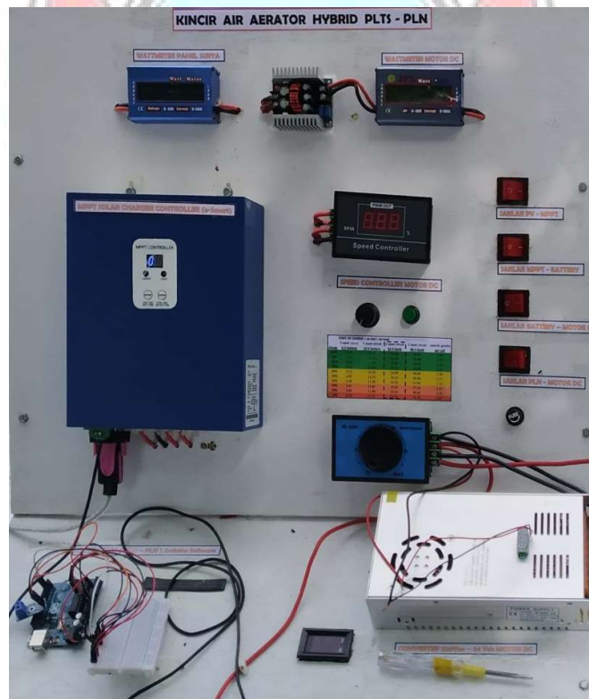
Gambar 2. Panel Kontrol Saklar Alih PLTS-PLN
