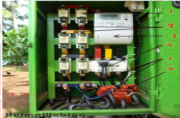
Gambar 12 Panel Hubung Bagi Tegangan Rendah (PHB TR)
