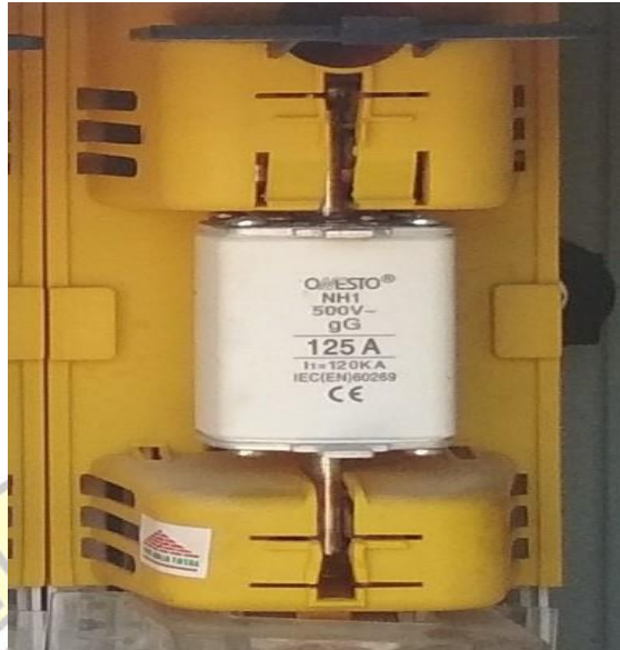
Gambar 17 NH fuse dalam kondisi baik
