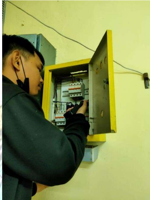
Gambar 16 Pengukuran arus AC di panel box Lantai 1 Gedung Administrasi.
