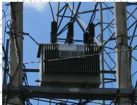
Gambar 2.14 Transformator (Sumber: PT. PLN (Persero) ULP Mattirotasi, 2021)
