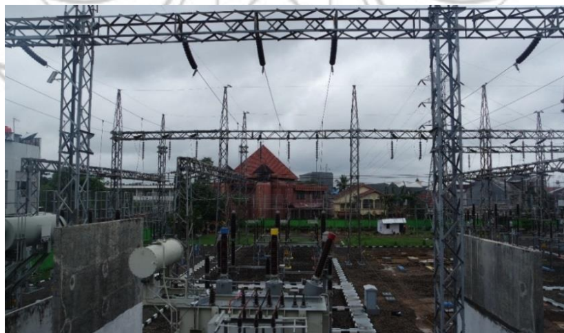
Gambar 2 Gardu Induk 150 KV
