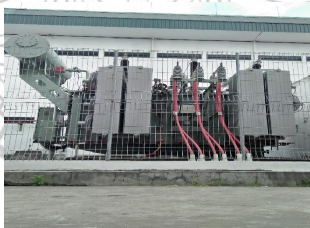
Gambar 18 Trafo Tenaga GIS
