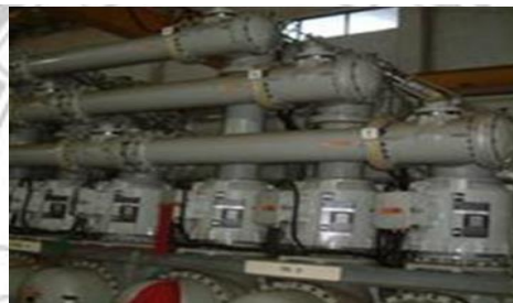
Gambar 21 Rel Daya ( Busbar ) Pada GIS
