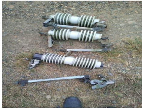
Gambar 4.5 kondisi FCO yang akan diganti
