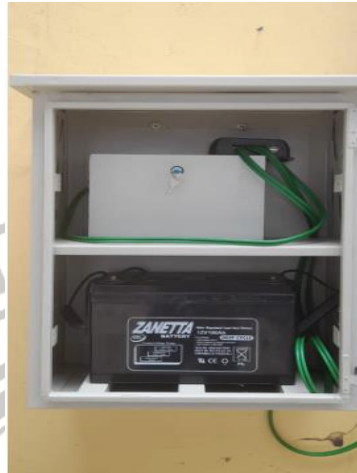
Gambar 3.9 Pemasangan hubungan antara panel mikrokontroler, SCC, dan accu
