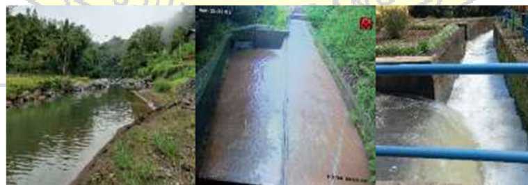
Gambar 5.14 Reservoir Alami, Saluran Waterway , Saluran Pelimpah, Dan Saluran Tailrace PLTMH PT.Tombolo Energi
