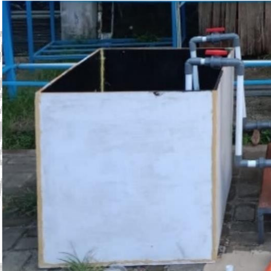
Gambar 4. 1 Drainage Pit (Sumber: Dokumentasi Pribadi)
