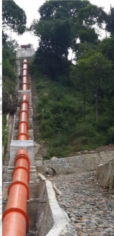
Gambar 2.1 Pipa Pesat PLT Minihidro Tombolo Energi
