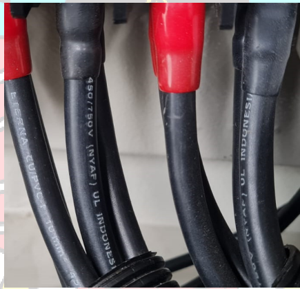
Gambar 4. 9 Gambar Kabel NYAF PLTS Eksisting
