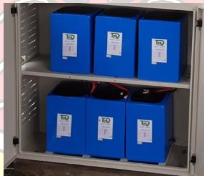
Gambar 4. 12 Kabinet Baterai Pada Panel Box MOV
