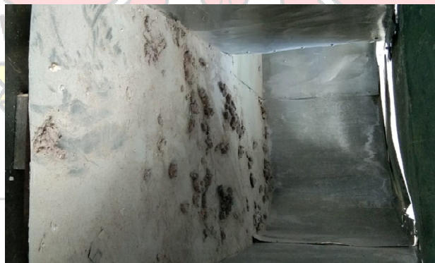
Gambar 3. Kondisi Saluran Udara sebelum dibersihkan
