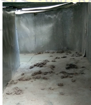
Gambar 4.10 Kondisi Saluran Udara sebelum dibersihkan
