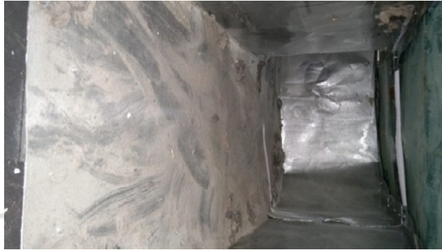
Gambar 4. Kondisi Saluran Udara setelah dibersihkan
