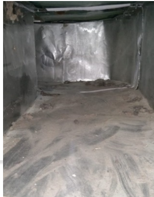
Gambar 4.11 Kondisi Saluran Udara setelah dibersihkan
