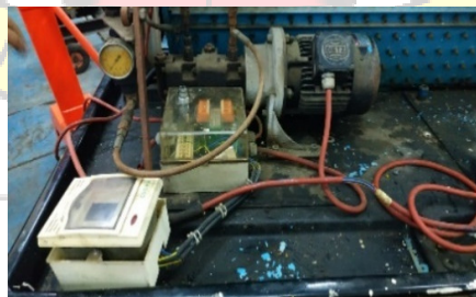
Gambar 3. 5 Kabel 3 Phase , TOR, Kontaktor dan MCB
