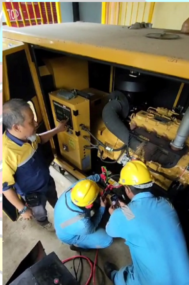
Gambar 4.4 Proses Pengujian Alat pada Genset
