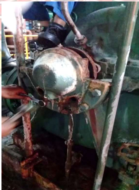
Gambar 4.3 Bearing Housing Pada Turbin Unit 2
