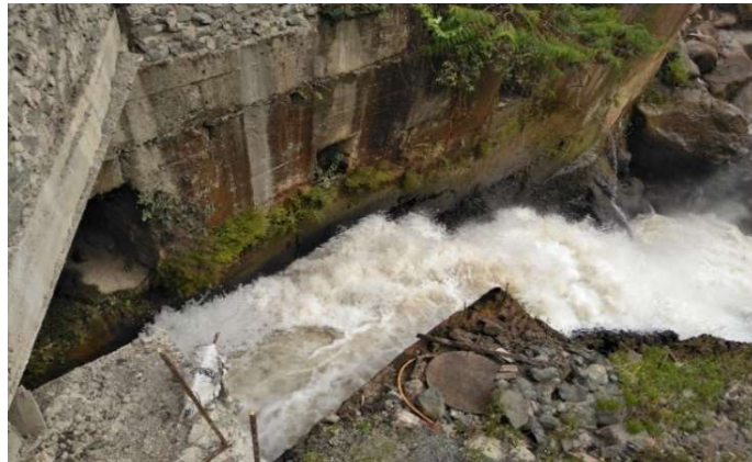
Gambar 2.14 Saluran Pembuangan ( Tailrace ) pada PLTM Malea
