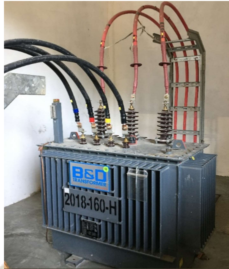
Gambar 2.11 Transformator Auxiliary pada PLTM Malea
