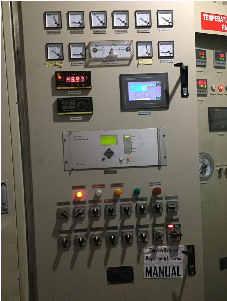
Lampiran 3. Control Panel pada PLTM Malca
