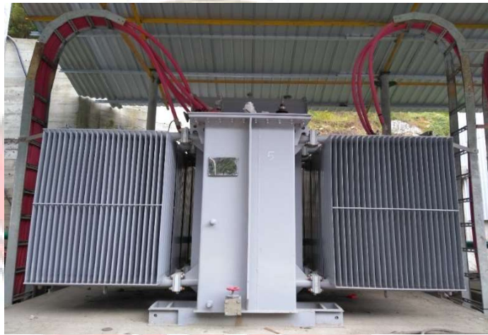
Gambar 2.10 Transformator Step-up pada PLTM Malea
