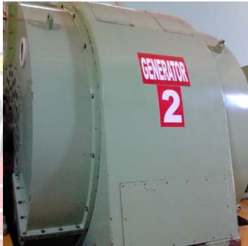
Gambar 2.6 Generator pada PLTM Malea
