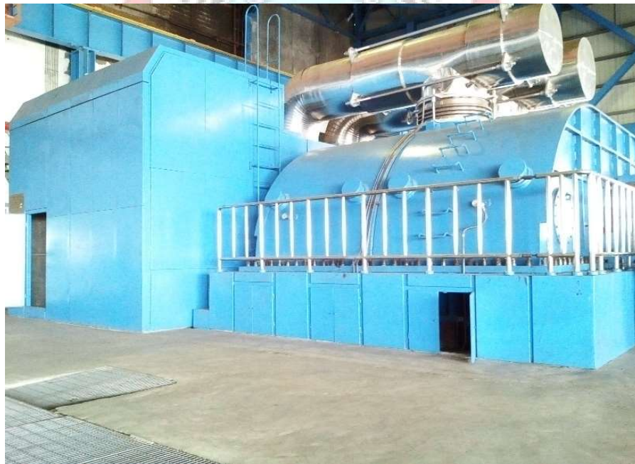
Gambar 2.5 Turbin Uap 125 MW PLTU Bosowa Energi Jenepono.
