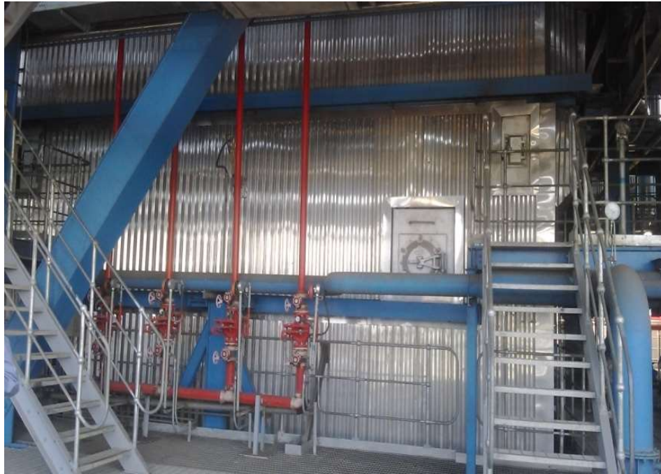
Gambar 2.4 Boiler Pulverized PLTU Bosowa Energi Jenepono.
