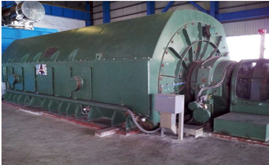
Gambar 2.7 Generator PLTU Bosowa Energi Jeneponto.
