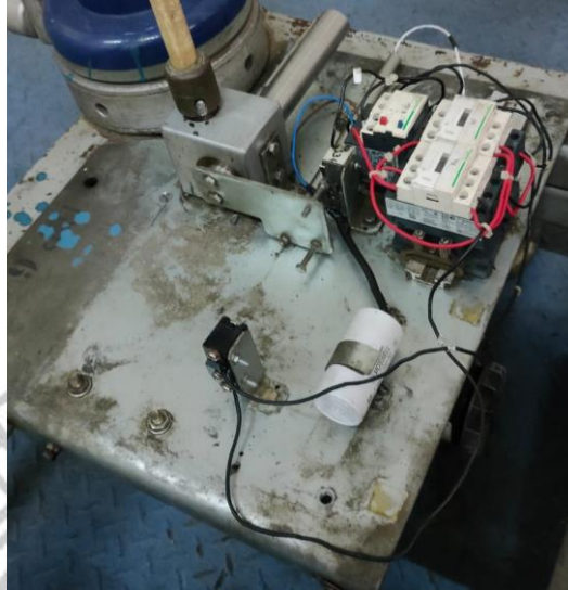
Gambar 4.4 Over Haul Kapasitor yang rusak
