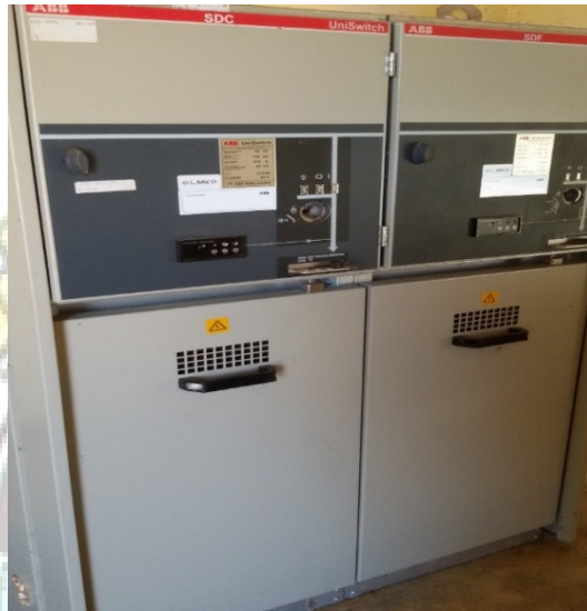
Gambar 1. Switch gear tegangan menengah 24 kV
