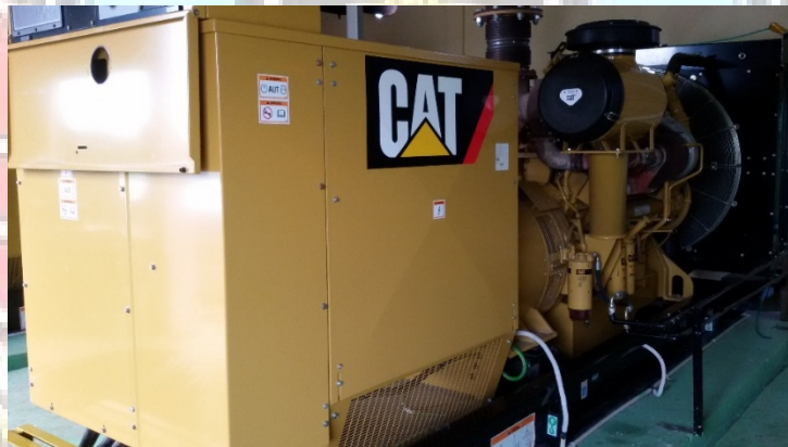
Gambar 3. Generator set dengan daya 810 kVA
