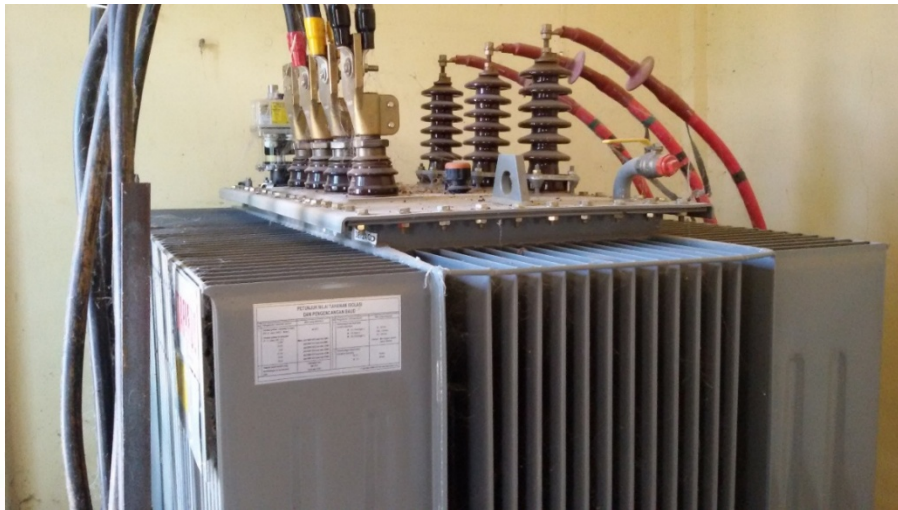
Gambar 2. Transformator kapasitas 1.000 kVA
