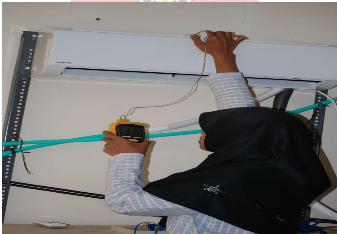
Foto. 8 Pengukuran Temperatur Udara Masuk & Keluar
