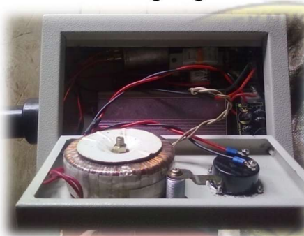
Rangkaian Panel Kontrol
