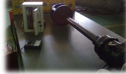
Turbin Picohydro dan Panel Kontrol
