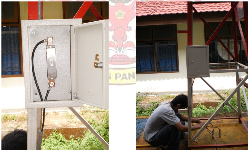
Lampiran 24. Box Panel Laightning Counter setelah terpasang dimenara/tiang
