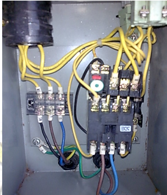
Gambar 19. Rangkaian panel control
