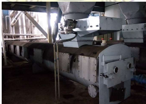
Gambar 2.11 Coal feeder Sumber : PLTU Barru.
