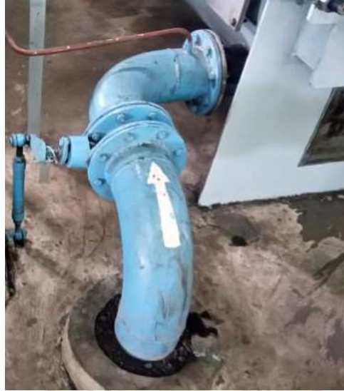
Gambar 2.18 Line Sealing Sumber : PLTU Barru.
