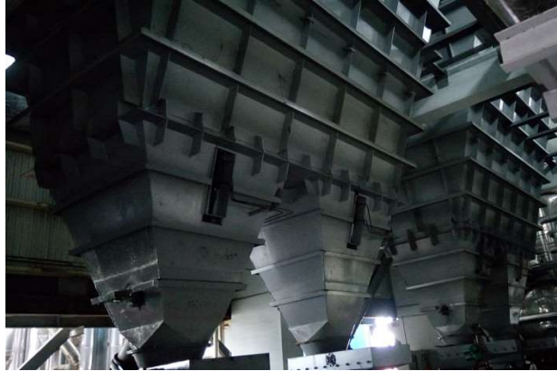
Gambar 2.10 Coal Bunker . Sumber : PLTU Barru.
