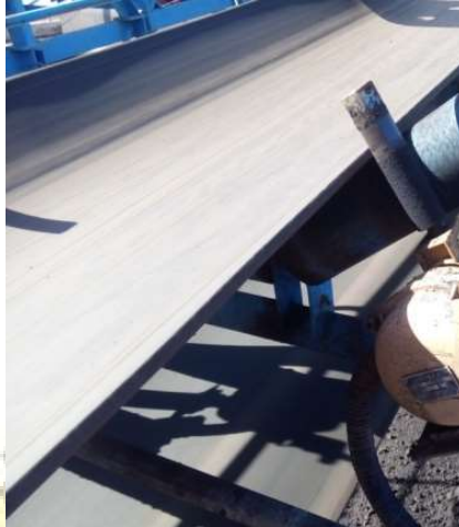
Gambar 2.20 Belt Conveyor . Sumber : PLTU Barru.
