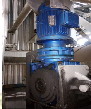
Gambar 2.16 Motor Belt Conveyor Sumber : PLTU Barru.
