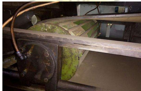
Gambar 2.19 Tail Pulley . Sumber : PLTU Barru.
