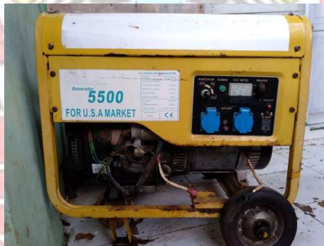
Gambar A. 5 Genset
