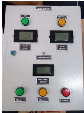
Gambar A. 1 Panel ATS-AMF
