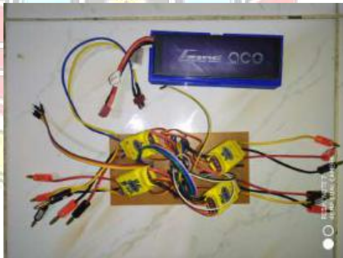
Gambar 4. 11 Perakitan Komponen pada Rangkaian Kontroler
