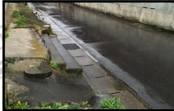
Gambar 2.6 : Drainase Saluran Tertutup
