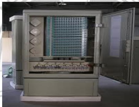
Gambar 2.8 Optical Distribution Cabinet (ODC)
