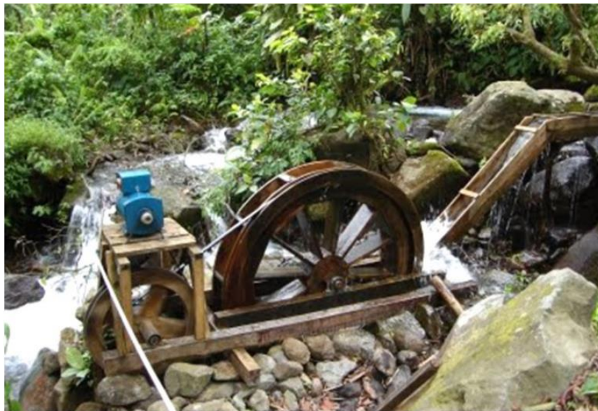
Gambar 1. Pembangkit Listrik Tenaga Mikro Hidro (listrikindonesia.com)
