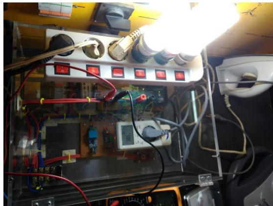
Gambar 5.17 Pengujian Beban Heater dan Lampu
