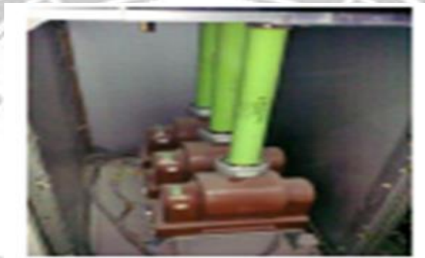
Gambar 23 Solefuse dalam melindungi trafo tegangan
