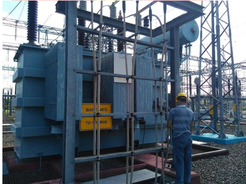
Gambar 28. Transformator 20 MVA gardu induk Kabupaten Sidrap
